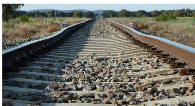
FIGURE 3 – Défaut (important) de nivellement
